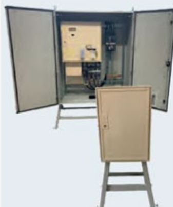
Coffrets de comptage (conforme ERDF)
